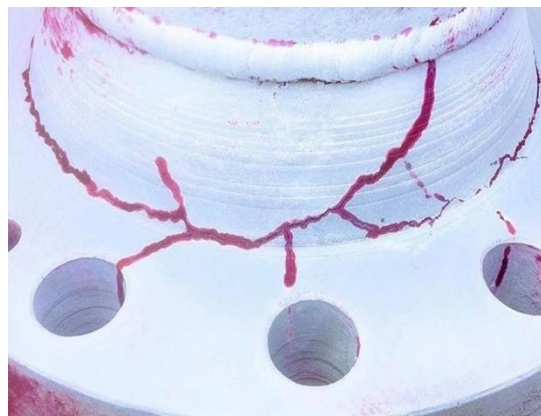
Figura 1.1 Breda con grietas evidenciadas con líquidos penetrantes.
